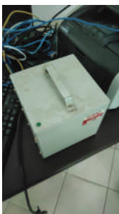
138. 1 Transformador VIMAQ 110 v - 220 v 3,3 v 300I id. 1489
