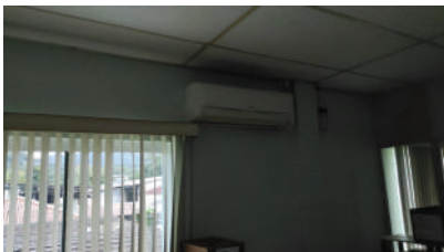
145. 2 Condicionadores de ar tipo split
