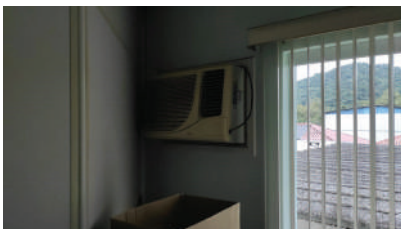
146. 2 Condicionadores de ar tipo caixa
