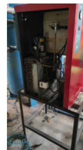
104. 1 Secador de ar CPX 270 Chicago - galpão da usinagem/ fundos
