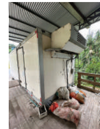
120. 1 Câmara fria com evaporador Trineve TRNA - 441 CN/2019
