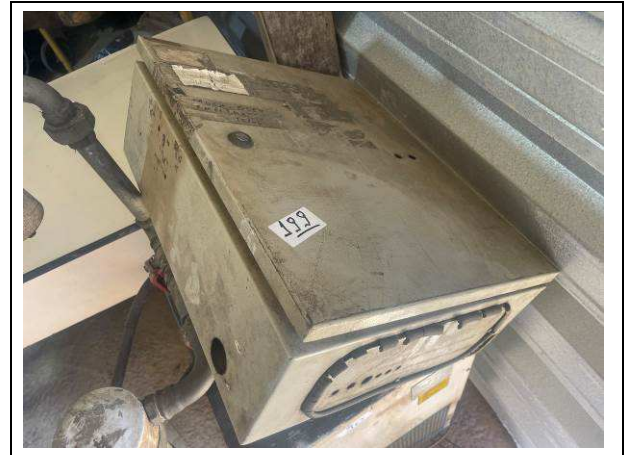
006 – ITEM 199 - QUADRO DE DISTRIBUIÇÃO DE ENERGIA, LUMIBRAS.
