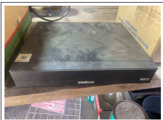
019 – ITEM 210.1 - GRAVADOR DE IMAGENS DVR, INTELBRAS / MHDX1016-C.
