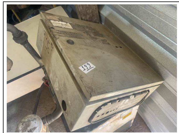
006 – ITEM 199 - QUADRO DE DISTRIBUIÇÃO DE ENERGIA, LUMIBRAS.
