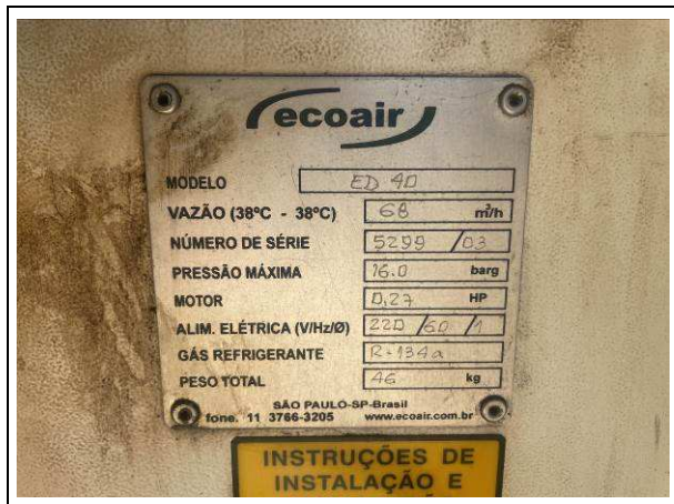
002 - ITEM 90 – SECADOR DE AR COMPRIMIDO, ECOAIR / ED40 (PLACA DE ESPECIFICAÇÕES).
