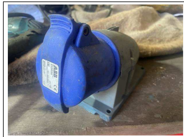
034 – ITEM 209.2 – TOMADA INDUSTRIAL DE EMBUTIR.
